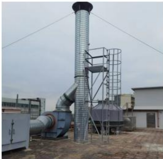
(采样口及采样平台图片)
